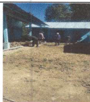
Foto 6: sustrucción de piso de torta de concreto
